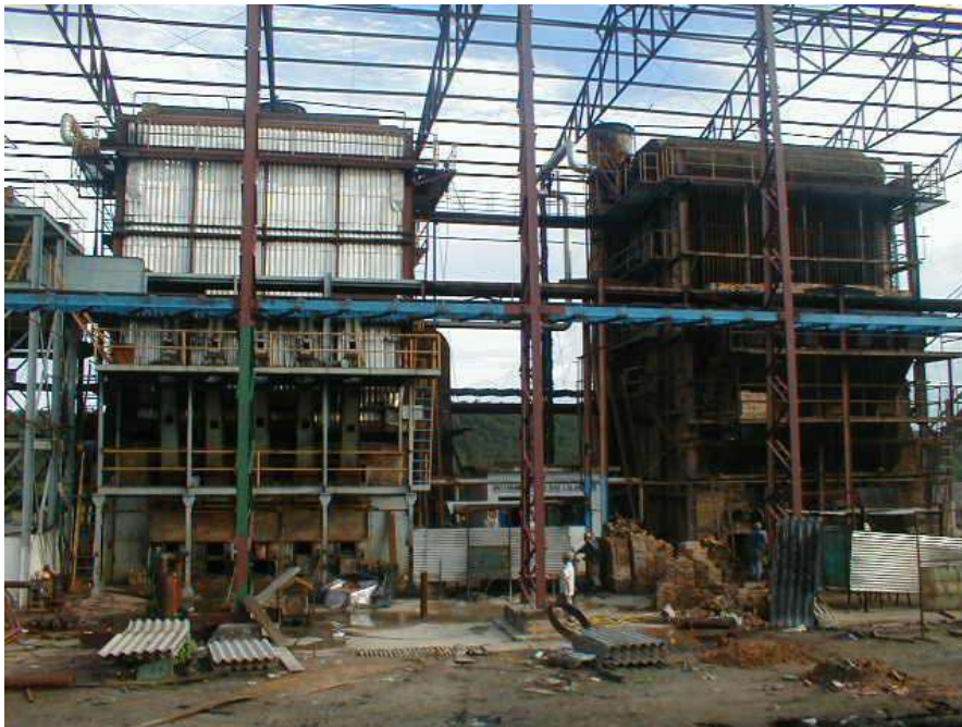
Foto 21: Caldeiras (em manutenção) Destilaria Pindorama
