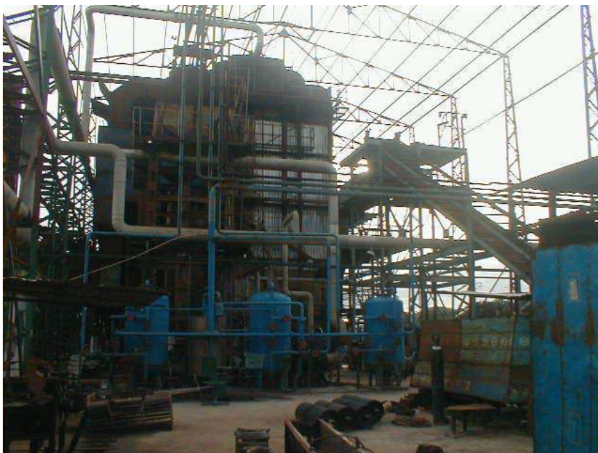
Foto 22: Caldeira (em manutenção) Destilaria Pindorama
