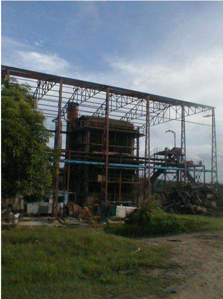
Foto 23: Caldeiras (em manutenção) Destilaria Pindorama
