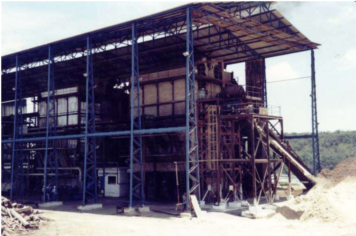
Foto 30: Caldeiras da Destilaria Pindorama (em operação)
