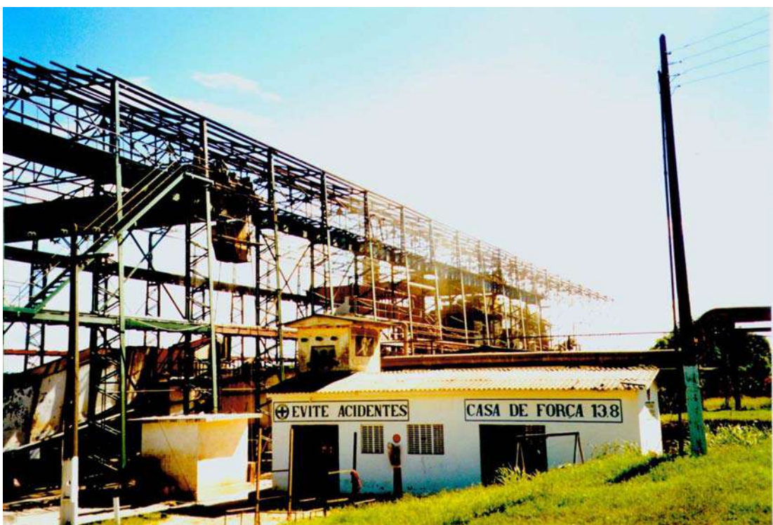
Foto 4: Vista da casa de força – Destilaria Pindorama
